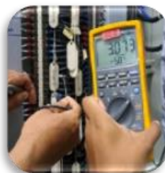
Gambar 10. Pengukuran Tegangan I/O Module
